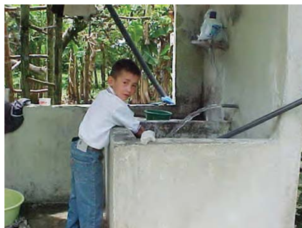
Puesto de agua Colombia. Fotografía: USAID.
